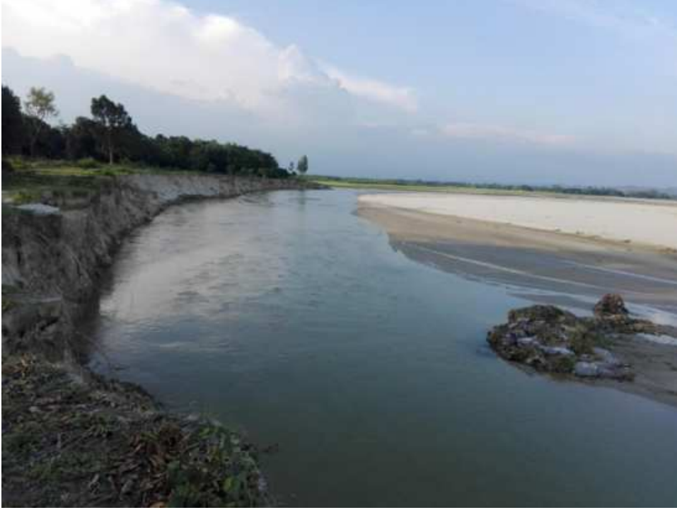
नदी कटान र वन तथा कृषि जमिनको क्षति संरक्षण गर्नुपर्ने स्थान, बलान नदी (२६.६६१११९/८६.४९७२७), लहान नगरपालिका-२३
